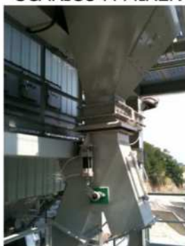
SCARICO A MIXER
